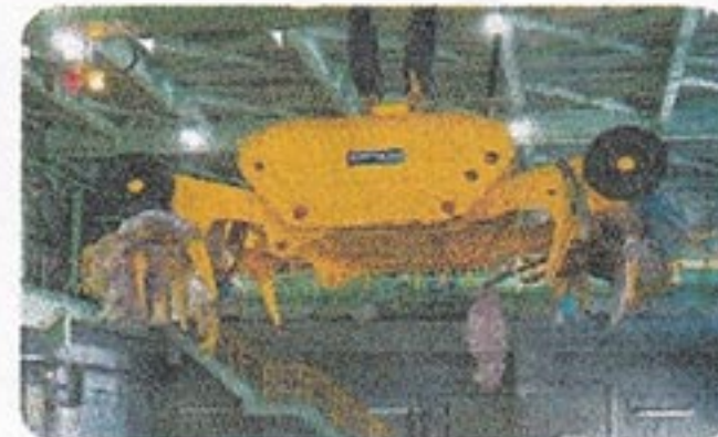
ゴミクレーン
